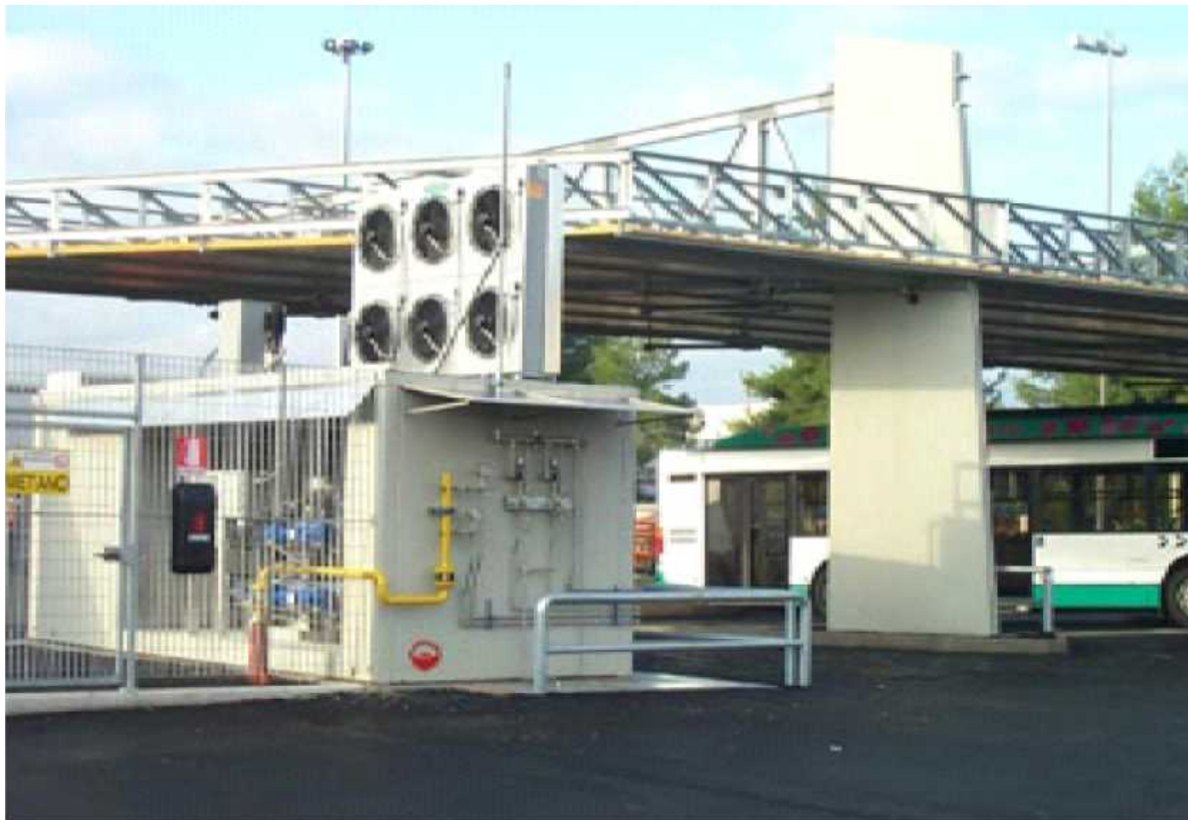
Compressore gas metano per impianti di distribuzione per autotrazione
