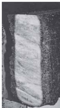
Figura 4.59: Trave di legno sottoposta ad incendio. Sotto lo strato carbonizzato il legno è ancora efficiente dal punto di vista meccanico.
