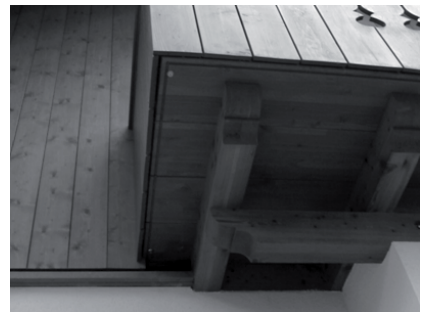
Figura 5.69: Balcone in legno di larice: travi distanti dai bordi e diverse rispetto a quelle del solaio, teste sagomate, assito con rompigoccia, parapetto distanziato dall'assito.
