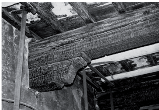
Figura 4.58: Solaio di legno non crollato a seguito di un incendio.
