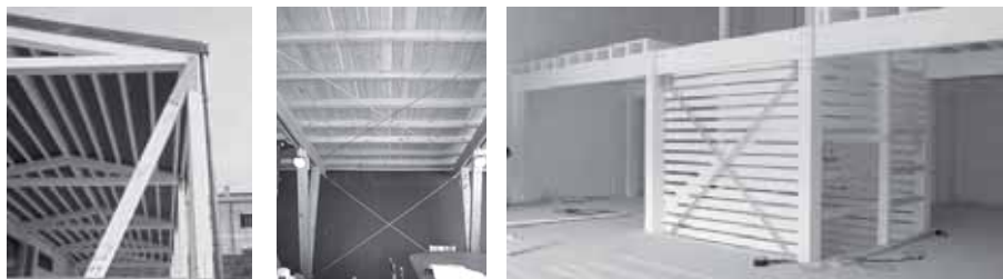
Figura 5.20: Diverse tipologie di controventi in edifici in legno a travi e pilastri (foto Valerio Rao).
