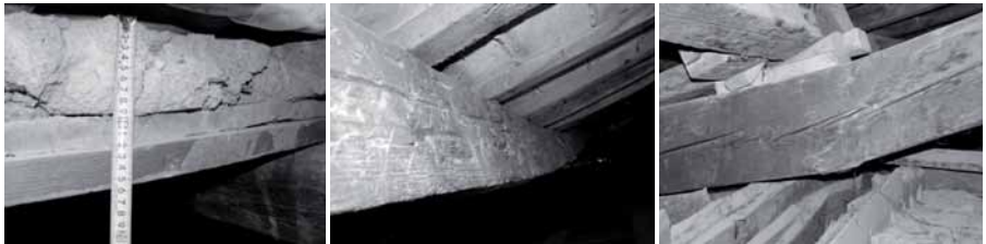
Figura 5.131: La realizzazione di una soletta di calcestruzzo sulla copertura di una chiesa ha portato nel giro di alcuni anni all'eccessiva deformazione di alcuni elementi ed al cedimento di altri.
