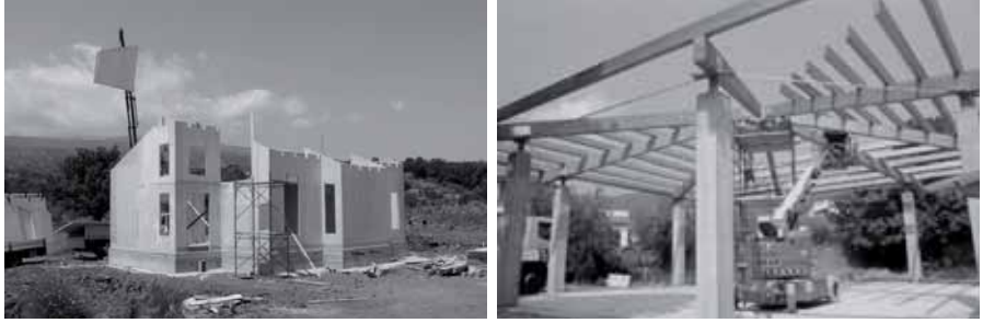
Figura 5.124: Utilizzo di autogrù per il montaggio delle strutture in un edificio a struttura di legno e di carrello elevatore per il montaggio di una copertura in un edificio monopiano.
