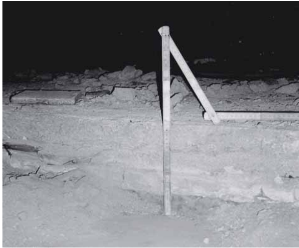
Figura 5.130: Per livellare il pavimento di questo solaio a struttura di legno sono stati aggiunti nel tempo vari strati di materiale inerte; ogni strato generava ulteriore inflessione, pertanto a distanza di alcuni anni il pavimento risultava daccapo avvallato; attualmente si evidenzia un riempimento che al centro raggiunge i 20cm e che ha provocato la rottura di alcuni elementi portanti. (Villa privata a Padova).
