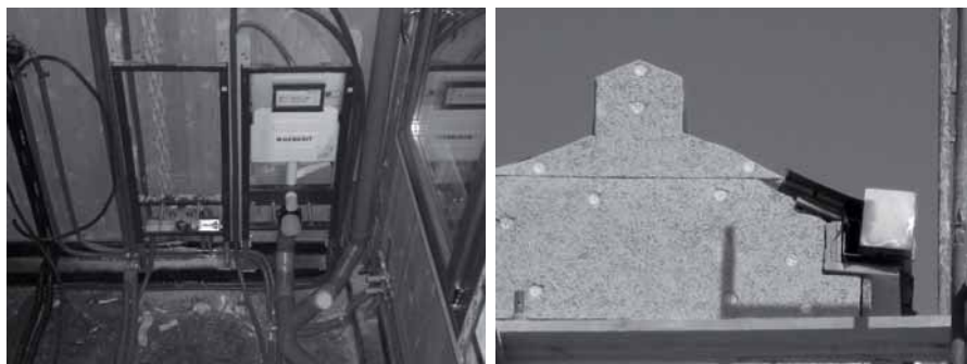
Figura 5.123: Posizionamento degli impianti sull'intercapedine interna della parete e dell'isolante esterno in pannelli di lana di legno mineralizzata fissati con connettori a vite sul lato esterno della parete.
