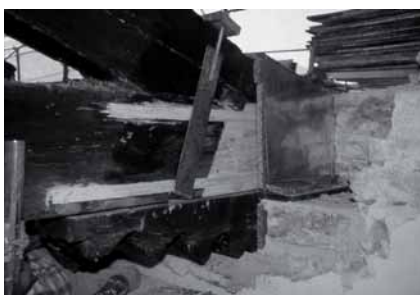
8 - Intervento eseguito, messa in opera della fascia metallica passiva. Prima della ricostruzione della muratura la testata viene trattata con prodotto preservante insetticida e fungicida, rivestita con foglio di sughero da 3cm e protetta con una cuffia di rame.
