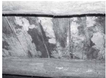
Figura 2.24: Miceli fungini sviluppatasi sul sottotetto di un edificio.
