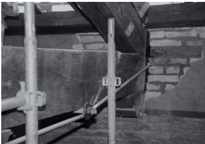
Figura 5.132: Affiancamento della catena di una capriata con tiranti metallici; l'intervento esonera completamente la catena lignea dalla sua funzione statica. Ciò è risultato necessario in quanto in fase di indagine diagnostica sono state rilevate sulla catena delle rotture imputabili alla cattiva qualità del materiale. (Cattedrale di Cesena).
