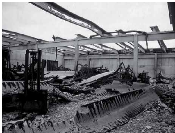
Figura 4.60: Capannone di cemento armato completamente distrutto a seguito di un incendio; le armature metalliche perdono resistenza e rigidità con l'aumento della temperatura, provocando rapidamente il crollo della struttura.
