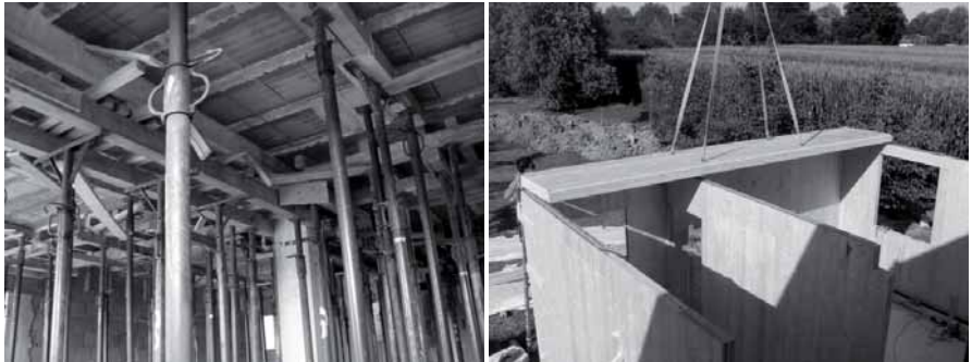
Figura 5.117: A sinistra puntellazione e cassetteria di un solaio di latero-cemento prima del getto. A destra posa di un pannello del solaio in un edificio a struttura di legno. Negli edifici a struttura di legno la struttura del solaio non ha necessità di essere puntellata, non deve essere contenuta in un cassero (spesso fatto di legno tra l'altro) che deve essere successivamente disarmato e smontato e può essere calpestata subito dopo il montaggio.
