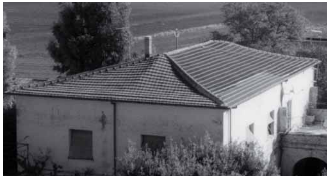
Figura 4.9: Deformazioni su una copertura di legno.
