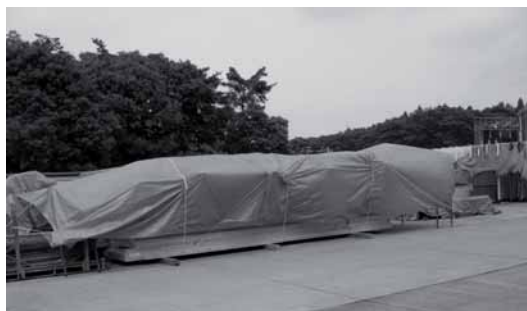
Figura 5.119: Stoccaggio ottimale in cantiere di pannelli portanti a strati incrociati. I pannelli sono sollevati da terra, distaccati fra loro e a protezione è stata realizzata una struttura provvisoria di protezione utilizzando teli in pvc. Il passaggio d'aria per tutti i pannelli ne assicura la corretta conservazione.
