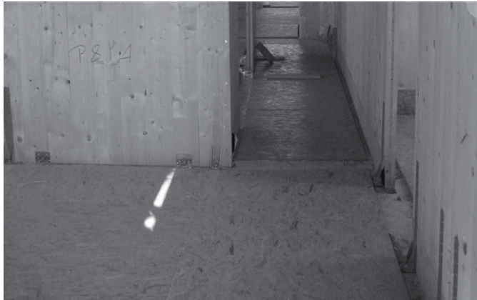
Figura 5.138: Collegamento diretto delle pareti alla platea di fondazione. Nella foto la platea è protetta da un foglio di OSB.
