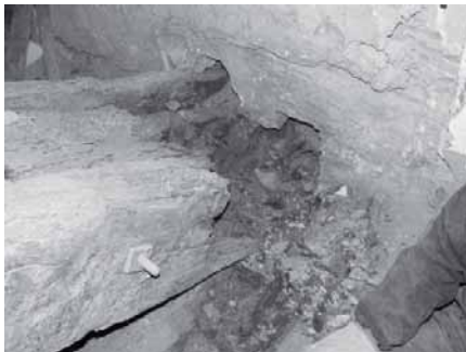
Figura 2.23: Esempio tipico di attacco fungino su trave: l'infestazione si è sviluppata nella zona di inserimento della trave lignea nella muratura.
