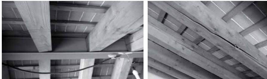
Figura 4.5: Nell'immagine a sinistra si nota la rotazione su di un appoggio, rotazione dovuta allo svergolamento della trave a seguito della stagionatura in opera. A destra invece un'altra trave della stessa copertura, trovandosi eccessivamente vincolata a torsione e non riuscendo quindi a ruotare sufficientemente agli appoggi, ha visto la fessura da ritiro passare da una faccia all'altra passando lo spigolo, determinando una vera e propria rottura per torsione. (Foto E. Nespolo).
