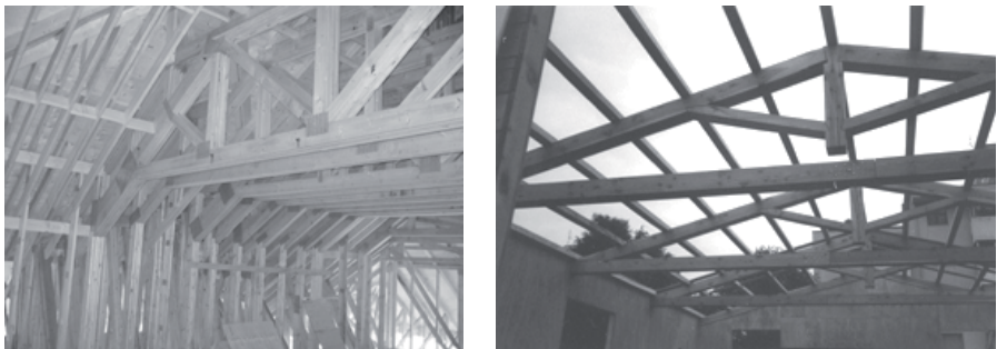
Figura 5.18: Copertura con travi reticolari collegate con piastre chiodate e copertura con capriate palladiane.
