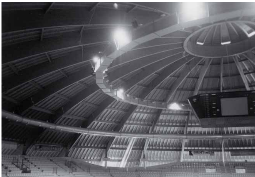
Figura 4.51: Struttura interamente realizzata di legno lamellare incollato con fondazioni di calcestruzzo e collegamenti di acciaio (Palasport di Livorno).
