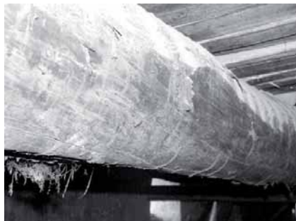
Figura 2.21: attacco di termiti su trave di castagno.
