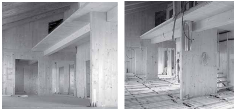
260 Figura 5.108: Casa per civile abitazione, spazi interni definiti dagli elementi strutturali in pannelli di legno portanti ed integrazione tecnologica di pavimento radiante (Casa Mazza, Linguaglossa, Catania).
