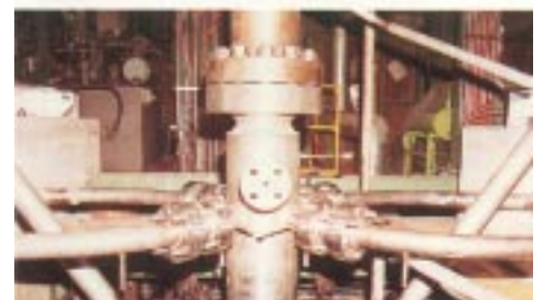
Circuito di prova presso la SIET
